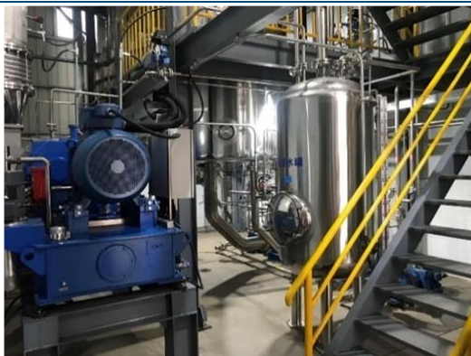
图表22: 金森制药MVR降膜浓缩器(甘草水提液)项目
