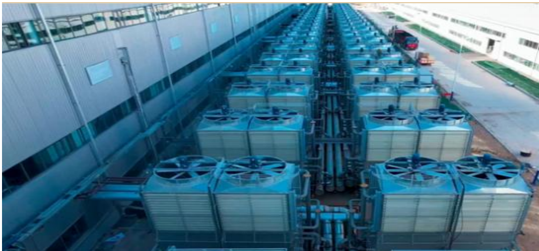
图 30：公司拉晶厂房外部配套建设节水消雾闭式循环水冷却项目
