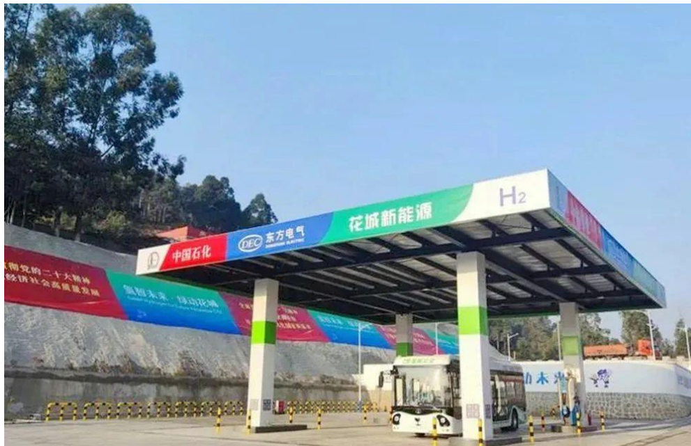
国内首个管道输氢母子加氢站——中国石化马店河加氢站
