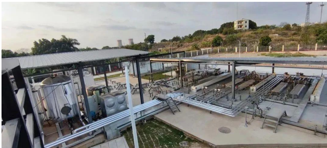
广州南沙电氢智慧能源站
