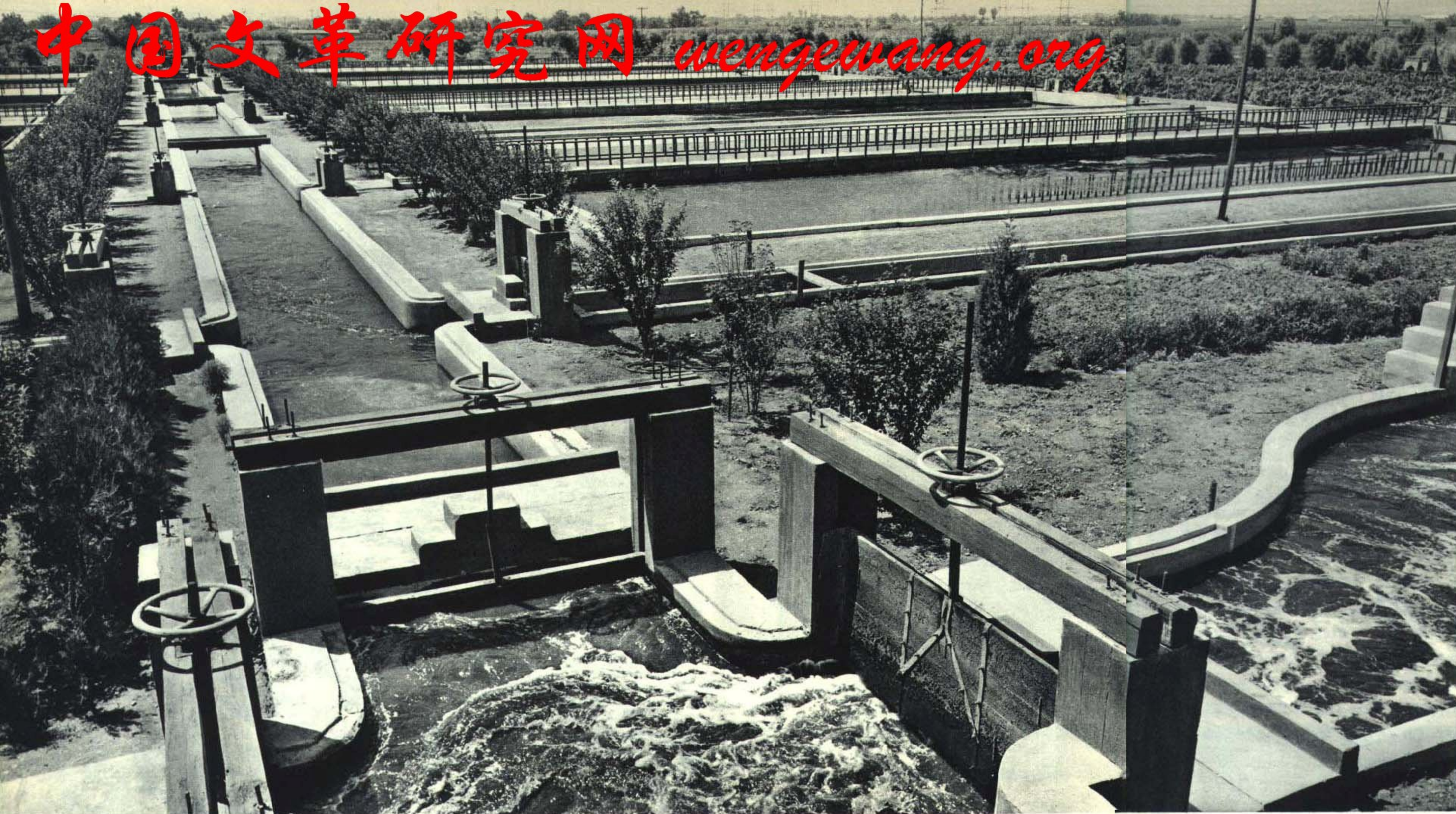
北京近年来兴建了几处污水泵站和污水处理场，用城市污水去灌溉菜田。这是污水处理场之一
